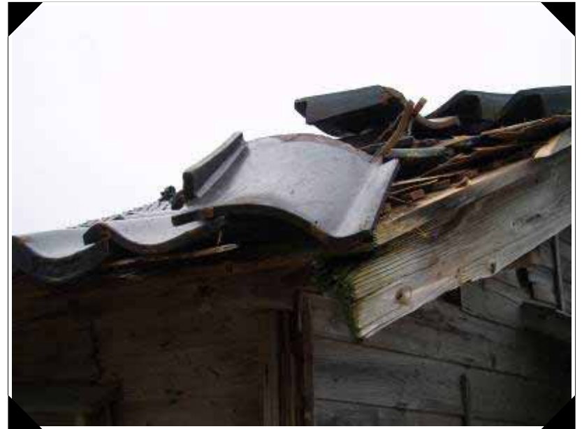
249号線以北の建物被害
