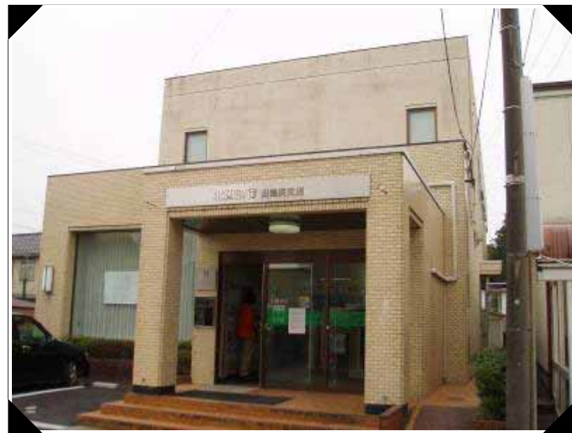
田鶴浜支所の南側周辺の建物被害
