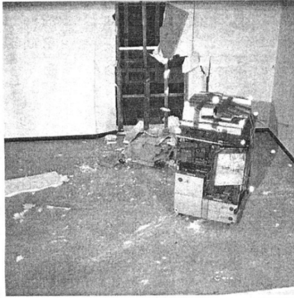
重さ100kgのコピー機が壁を突き破った(兵庫県三木市の実験施設)
