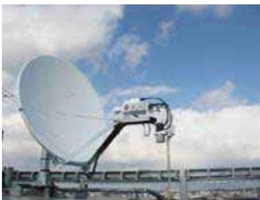
図 2-2 自治体衛星通信用パラボラアンテナ
