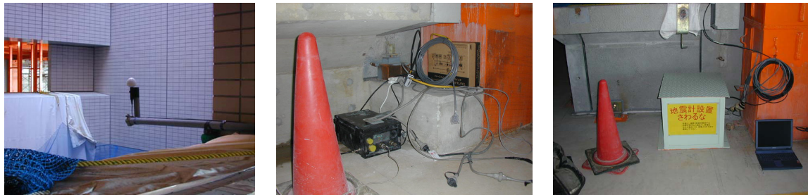
(a) GPS アンテナ (b) 強震計 (c) 養生後の強震計
