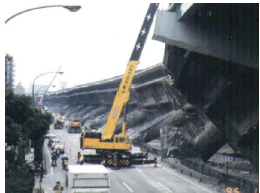
写真-1 阪神・淡路大震災の高架橋被害
