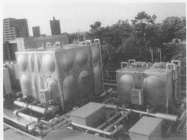
写真5 屋上貯水タンク
