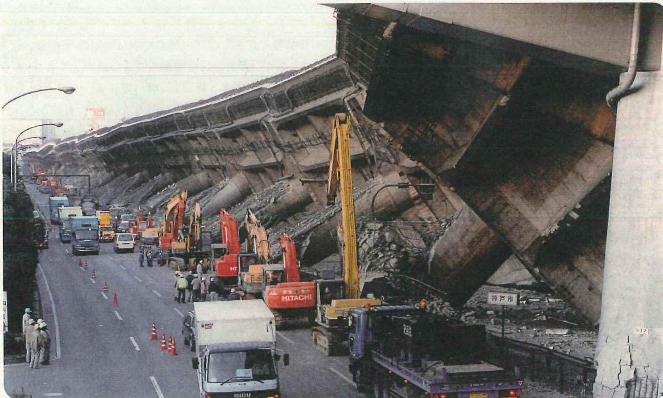
阪神・淡路大震災により倒壊した阪神高速道路3号神戸線
