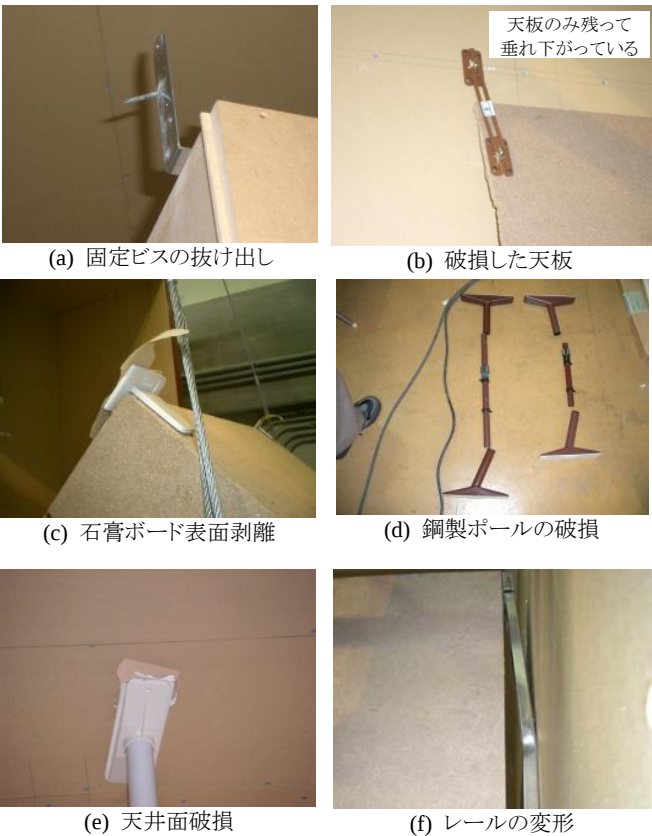
写真2 実験後、破損状況
